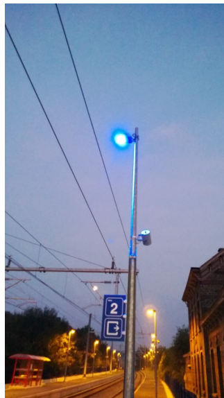
شکل ۱۲: نمونه چراغ های آبی نصب شده در راه آهن های دنیا
