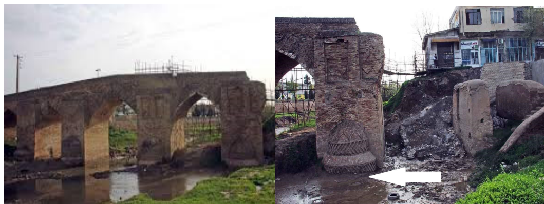
شکل ۱۱- آبستگی موضعی در اطراف کوله ها و پایه ها پل گرگانرود
